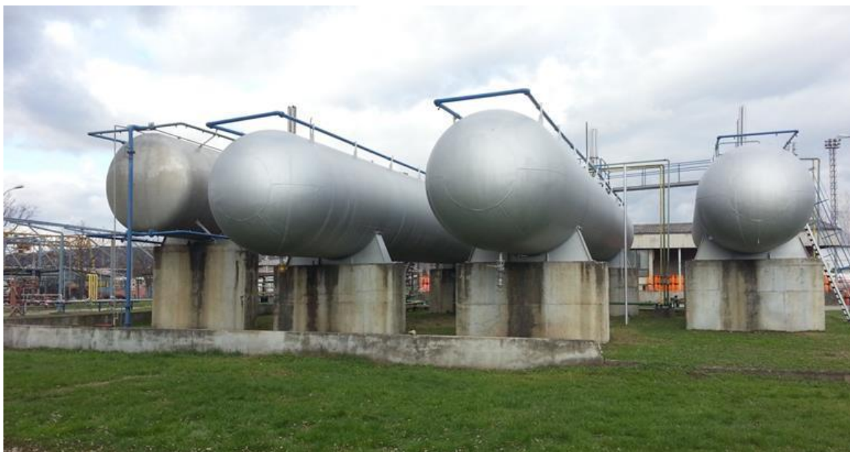
Slika 32: Horizontalni valjkasti spremnici UNP 150 m 3 na području postrojenja UNP2 Slavonski Brod
